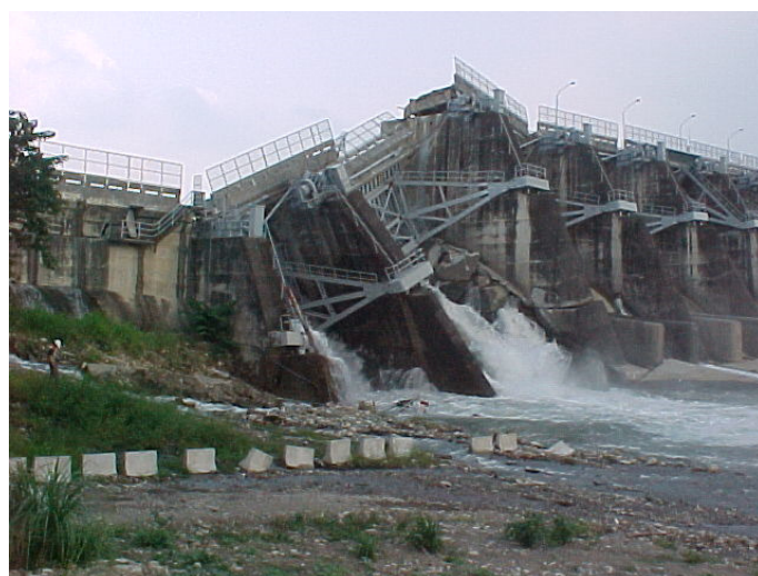
Bild 1: Während eines Erdbebens 1999 brach die Shih-Kang Staumauer in Taiwan durch Verschiebungen der Gründung entlang einer Störungszone (Bildquelle: http://gees.usc.edu ).
