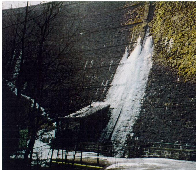
Bild 2: Eisfahnen an einer Bruchstein-Staumauer zeigen die unplanmäßige Durchsickerung (Bildquelle: Ruhrverband).
